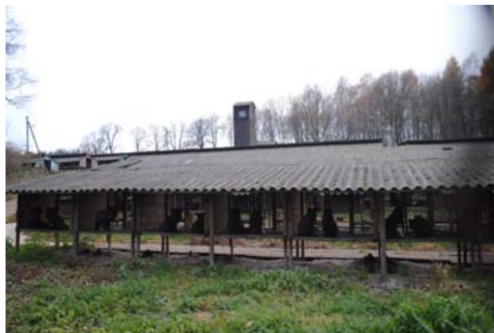
Baterie klatkowe na fermie lisów w Wałbrzychu
